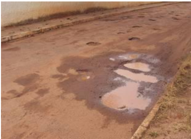
Figura 16: Araguaína: Imagens do quadro deteriorado da infraestrutura urbana do Setor Vila Aliança.
