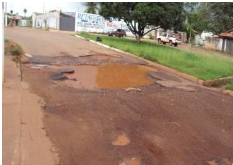
Figura 18: Araguaína: As cenas do quadro deteriorado da infraestrutura urbana se repetem também na Vila Couto Magalhães, considerado o primeiro Setor a receber políticas públicas de moradia social desta cidade.
