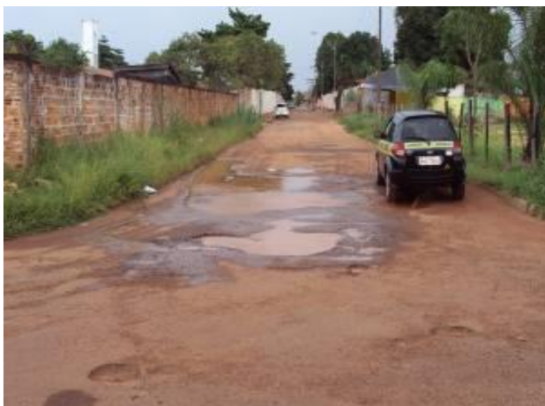
Figura 17: Araguaína: Imagens do quadro deteriorado da infraestrutura urbana do Setor Vila Aliança.
