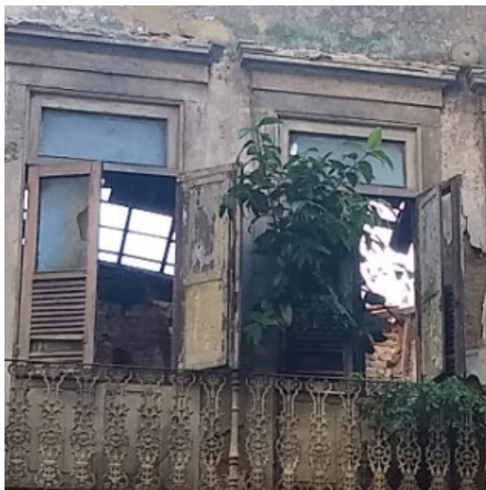
Figura 4 Imóvel na Rua Gomes Freire, no Centro do Rio de Janeiro. Acervo: Morgana Valim
